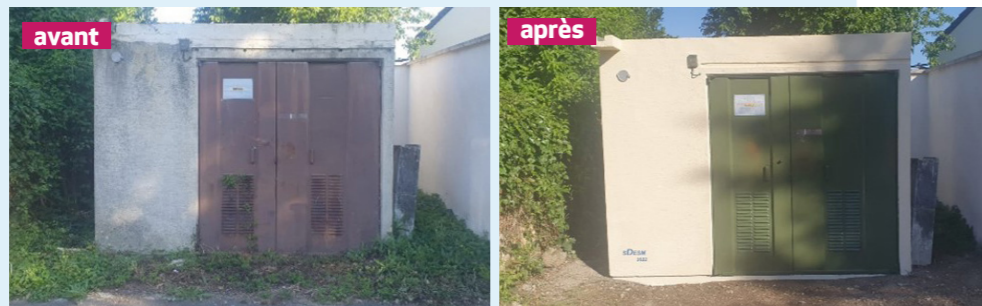
► Poste Torpille situé à Saint-Germain-Laxis rénové par Initiatives77
