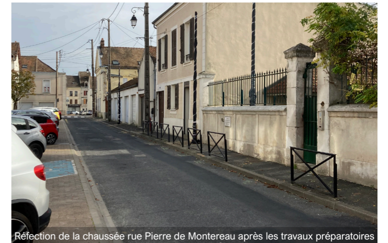
Réfection de la chaussée rue Pierre de Montereau après les travaux préparatoires
