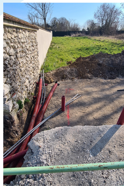
Emplacement futur poste de transformation
