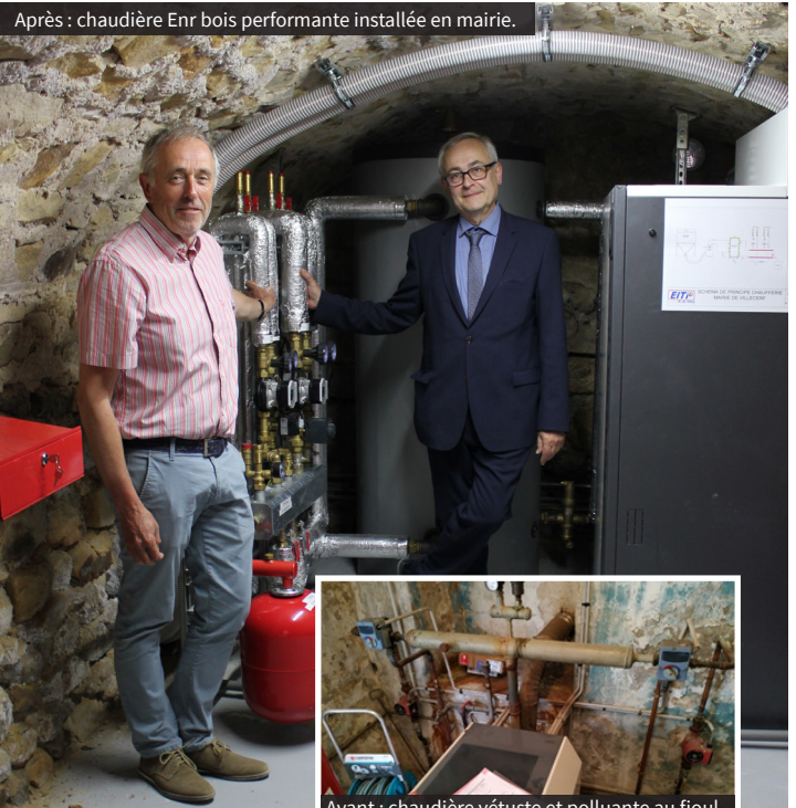
Avant : chaudière vétuste et polluante au fioul
